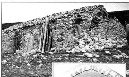
Obras de recuperación de la ermita de San Bartolomé en Nestares, dirigidas por Gustavo Cenzano en 1982 y 1983. Interior y fachada sur donde ha sido añadido un refugio.
